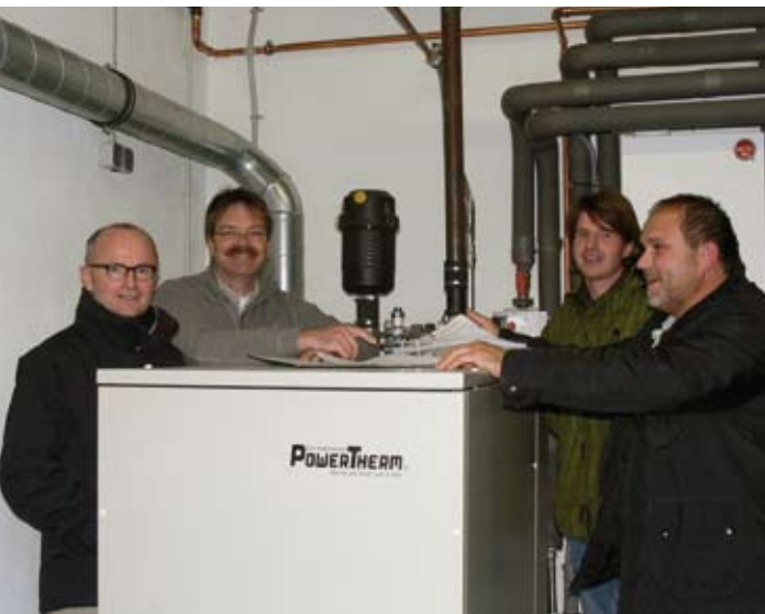
Das Blockheizkraftwerk war eine zukunftsweisende Entscheidung, sind Reinhard-Ehmke Sohns (v.l.), Werkstattleiter Eckhard Blank, Dirk Jaetzel und Peter Kuhnke sicher.
